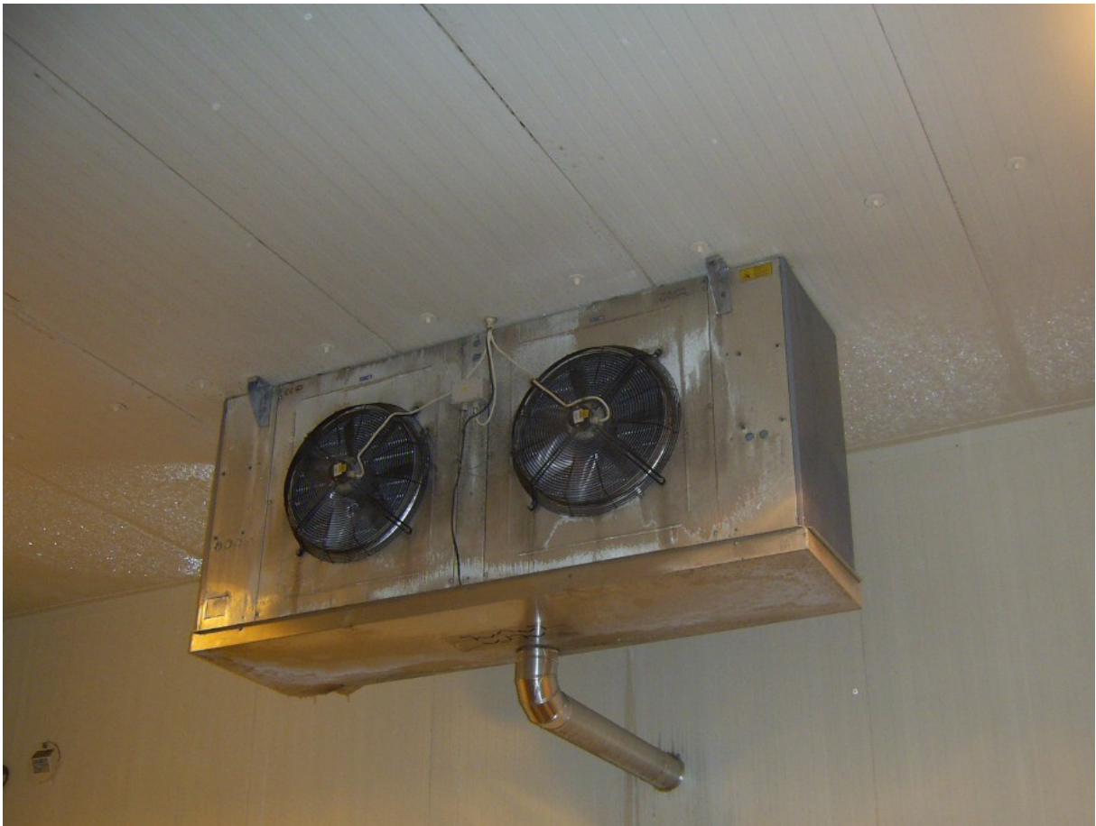
(fot.7 Detektor umieszczony zbyt blisko wlotów i wylotów wentylacji jak na powyższym zdjęciu nie będzie prawidłowo realizował pomiaru.)
