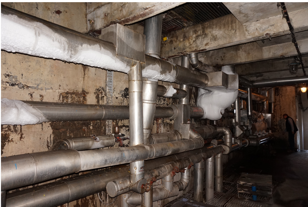
(fot.1 W instalacjach o starszej konstrukcji drobne wycieki są na tyle częste, że monitoring o wysokiej czułości nie będzie skuteczny, a sensory pracujące w takich warunkach szybko utracą swoje właściwości pomiarowe)
