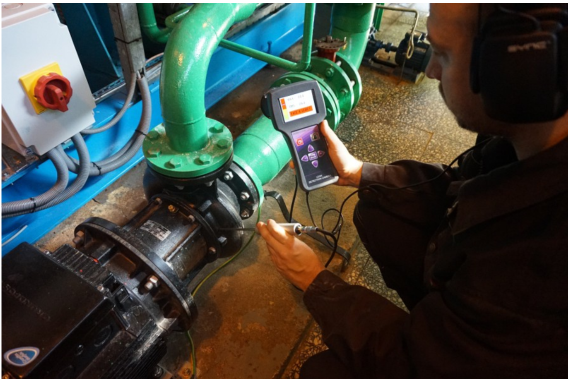
(fot.14 Diagnostyka elementów wirujących za pomocą wykrywacza ultradźwiękowego LEAKSHOOTER i sondy dotykowej TOUCH PROBE)
