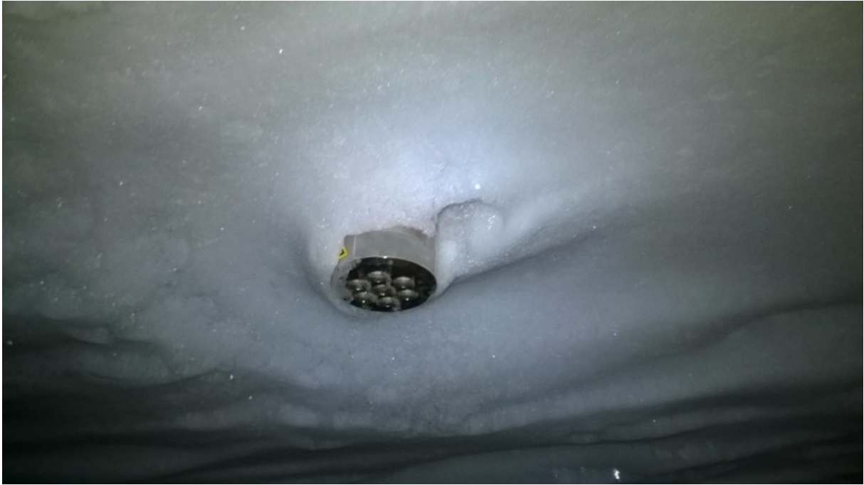
(fot.6 Nawet najlepszy detektor z oblodzonym wlotem nie spełni swojej roli. Należy przy umieszczeniu urządzeń przewidzieć czy w danym miejscu będzie się tworzyć pokrywa lodowa.)
