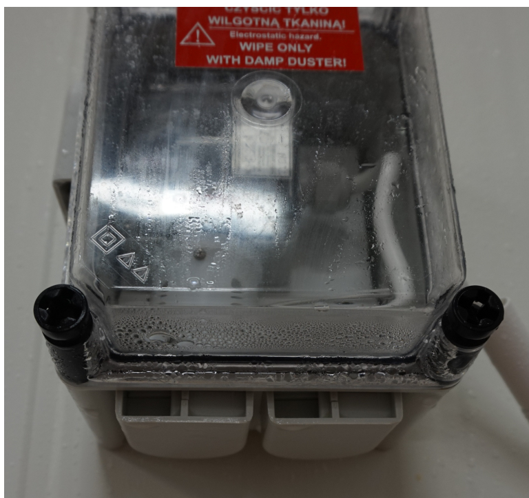
(fot.8 Przykład kondensacji pary wodnej na osłonie bryzgoszczelnej detektora w chłodni.)
