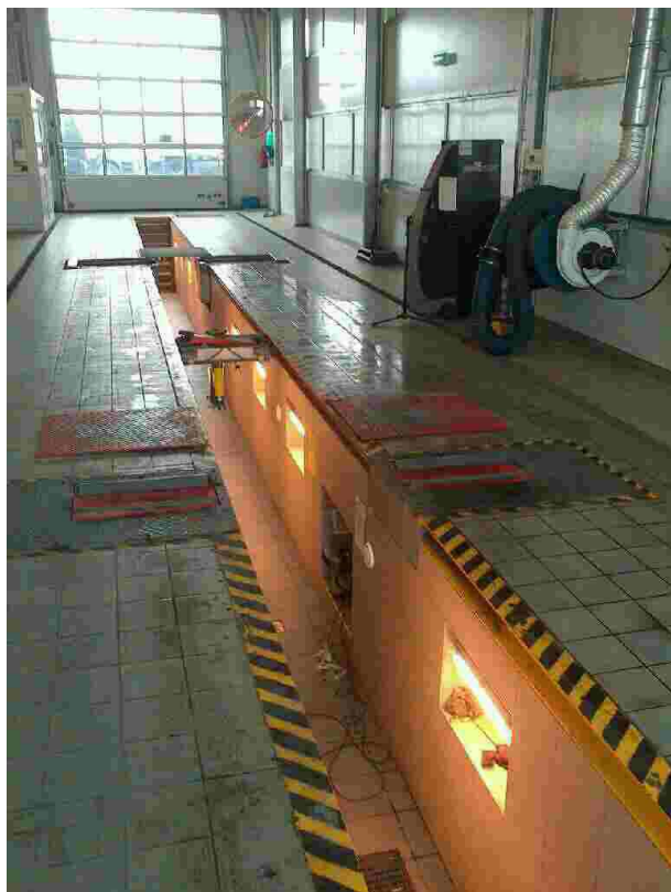
Fot.5 Kanał rewizyjny na stacji kontroli pojazdów. Widoczne wnęki dla osprzętu (m.in. dla detektorów).
