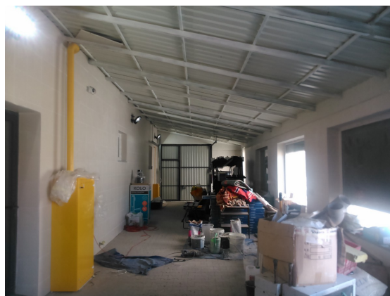
(fot.12 Nieprawidłowo zlokalizowana skrzynka gazowa wraz z zaworem elektromagnetycznym)
