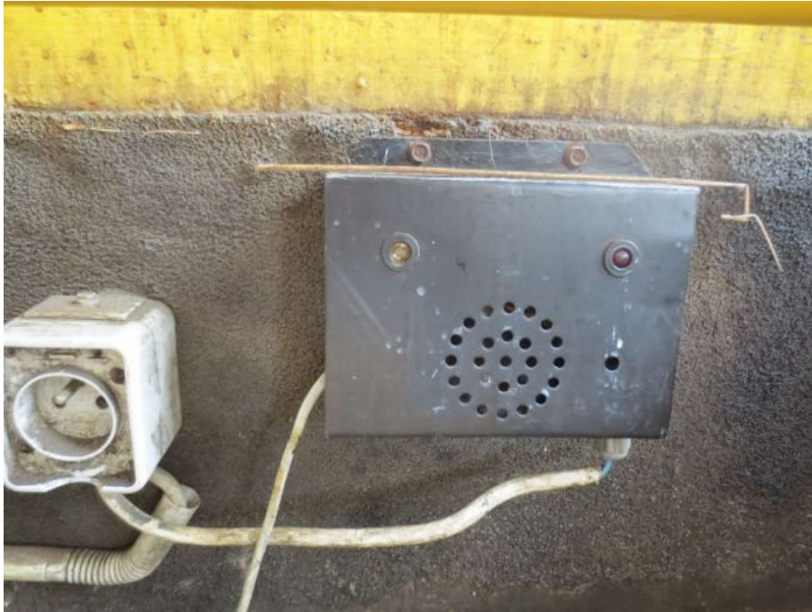
(fot.1 Przykład nieprawidłowego wykonania zasilania detektora z obwodu ogólnoużytkowych gniazd wtykowych.)
