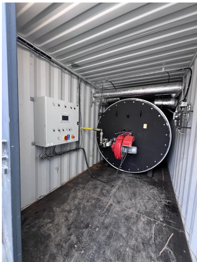
(fot.11 wnętrze kotłowni kontenerowej. Widoczna mała ilość miejsca utrudniająca migrację gazu oraz ewentualny dostęp serwisowy do elementów systemu detekcji.)
