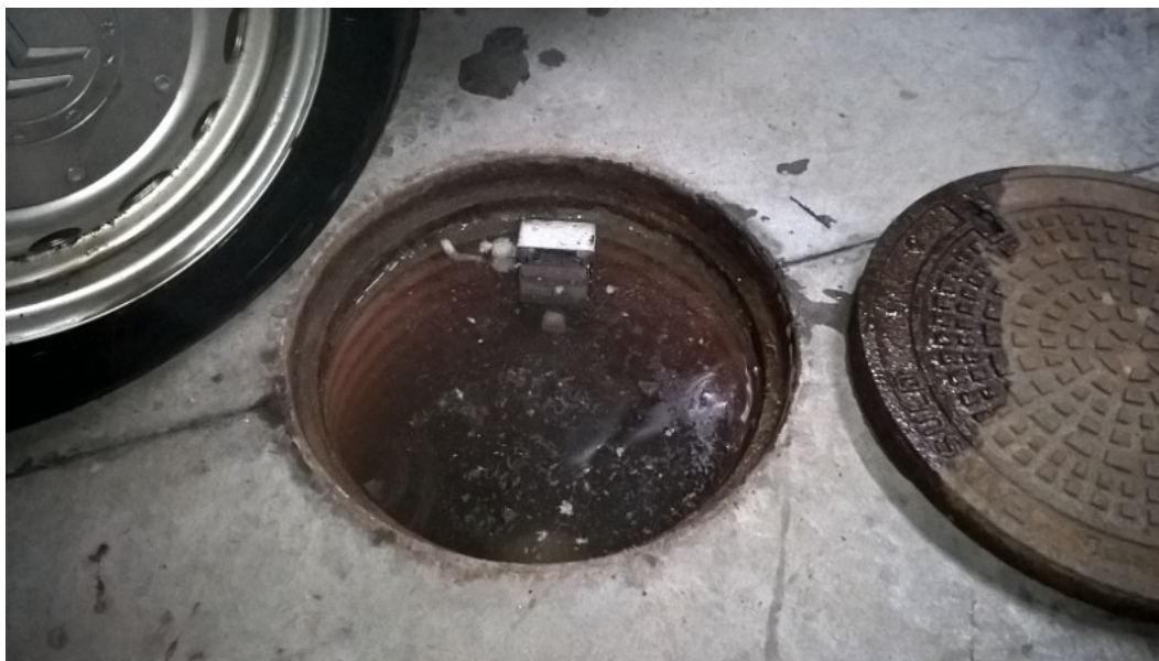
(fot.6 Detektor zasilany 230VAC umieszczony w studzience kanalizacyjnej hali garażowej. Ponieważ w garażach nie stosuje się ochronnych urządzeń różnicowo-prądowych detektor cały czas był pod napięciem. Tego typu instalacje są niedopuszczalne. Detektory nie są przeznaczone do pracy w takich warunkach. Hala garażowa ze studzienkami nie powinna zostać dopuszczona do parkowania pojazdów LPG.)
