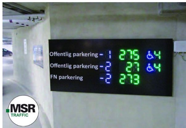
(fot.1 Tablica systemu wskazywania wolnych miejsc parkingowych MSR-Traffic wielopoziomowej hali garażowej.)
