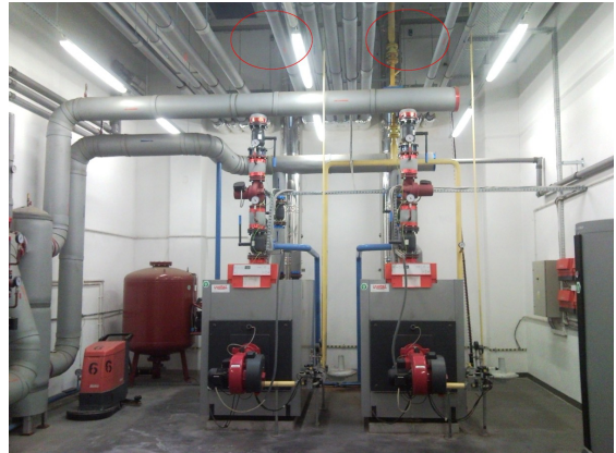
(fot.5 przykład złego doboru i braku dostępu serwisowego)
