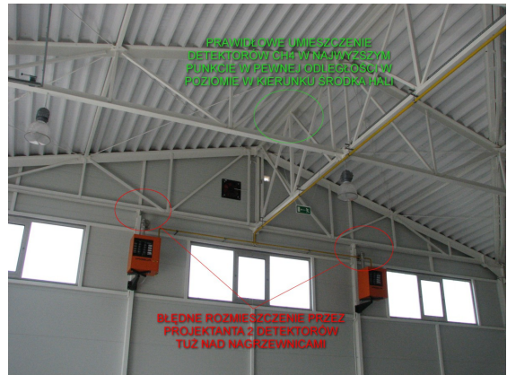
(fot.6 przykład złego doboru detektorów na hali)
