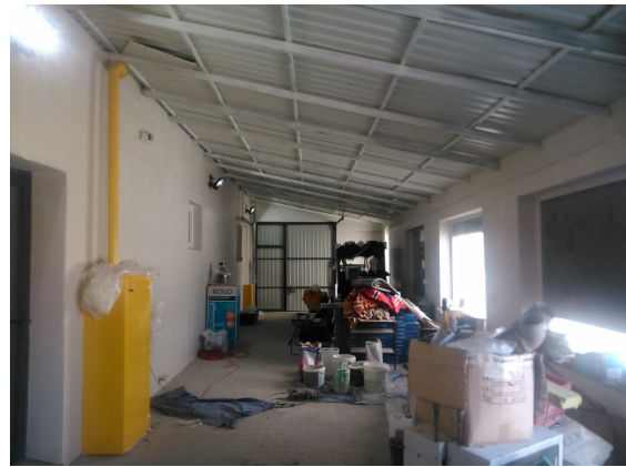
(fot.9 Nieprawidłowo zlokalizowana skrzynka gazowa wraz z zaworem elektromagnetycznym)
