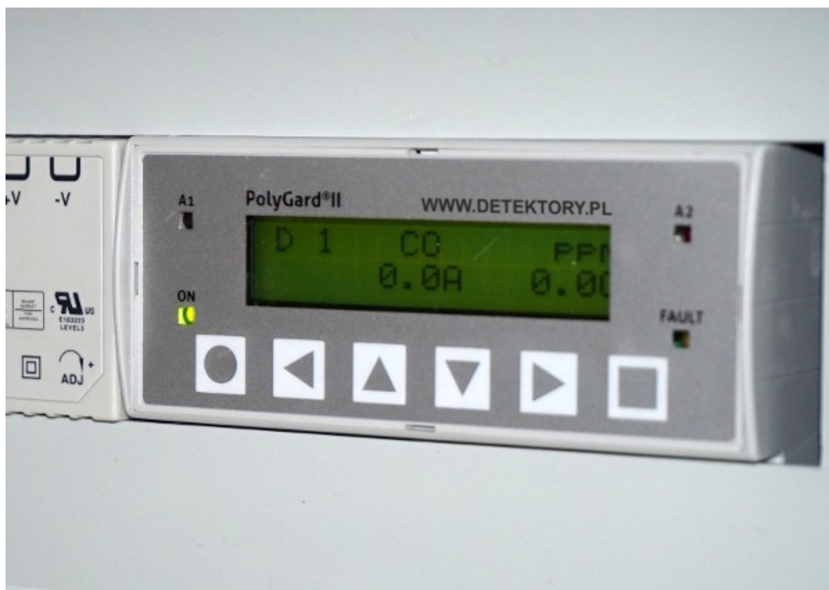
(fot.6 Na zdjęciu centrala cyfrowa PolyGard2 z podglądem detektora. Ciekawostką w tej centrali jest możliwość podglądu wartości bieżącej (C) – po prawej, oraz wartości średniej (A) – po lewej. Funkcja przydatna przy pomiarze gazów toksycznych gdzie istotna jest średnia z danego okresu czasu lub przy eliminowaniu krótkotrwałych przekroczeń poziomu mogących niepotrzebnie wywoływać sytuację alarmową)
