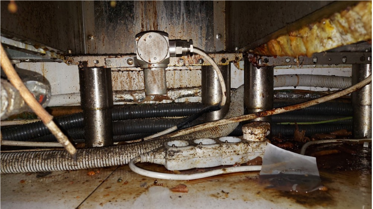
(fot.4 Detektor propanu-butanu w typowych warunkach pracy w lokalu gastronomicznym. Urządzenia o niskim stopniu ochrony bardzo szybko ulegają zniszczeniu. Warto zwrócić uwagę, że głównym problemem jest oblepiający wszystko tłuszcz. To powoduje, że urządzenia bez dodatkowych osłon szybko zostaną zalepione i ochrona będzie nieskuteczna.)
