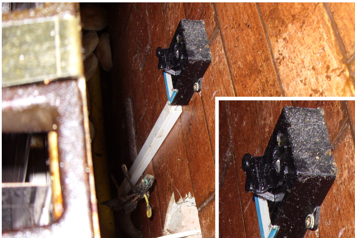
(fot.10 Detektor Umiejscowiony za kuchenkami. Ciepło wydzielane z urządzeń nie tylko przekraczało dopuszczalny zakres temperatur pracy detektora, ale także spowodowało stopienie części obudowy detektora.)
