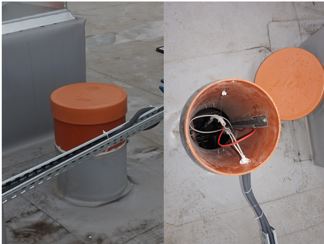
(fot.12 Przykład wykonania dostępu do detektora od strony dachu na jednej z galerii handlowych.)
