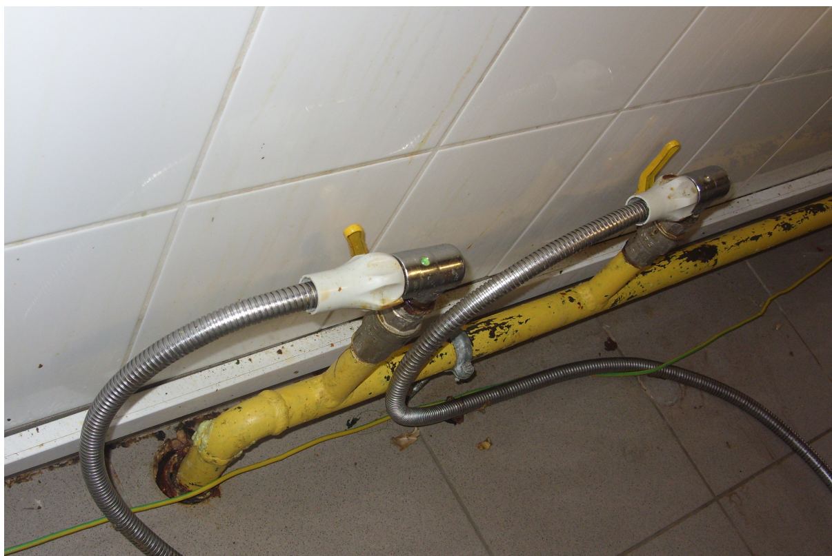
(fot.1 Instalacja gazowa w lokalu gastronomicznym z widocznymi przewodami elastycznymi i szybkozłączami stosowane aby ułatwić odsuwanie urządzeń i czyszczenie pomieszczenia.)
