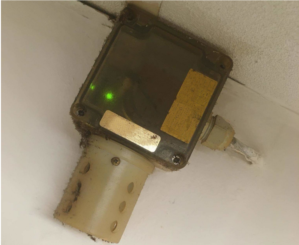
(fot.9 Widoczne znaczne zanieczyszczenia na detektorze. Głównym problemem mogą być drobiny tłuszczu w powietrzu oblepiające urządzenie i wrażliwe elementy sensoryczne. Dlatego ważna jest odpowiednia ochrona IP66 i lokalizacja, która zredukuje narażenie detektora.)
