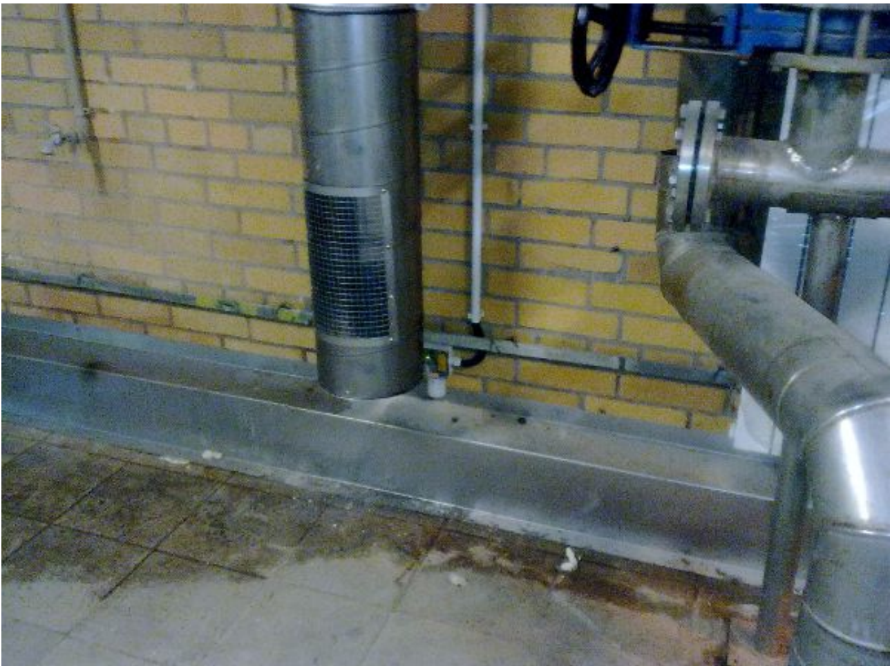
(fot.6 Detektor umieszczony zbyt blisko wlotów i wylotów wentylacji jak na powyższym zdjęciu nie będzie prawidłowo realizował pomiaru.)
